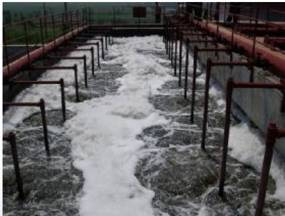
污水排放 sewage discharge
